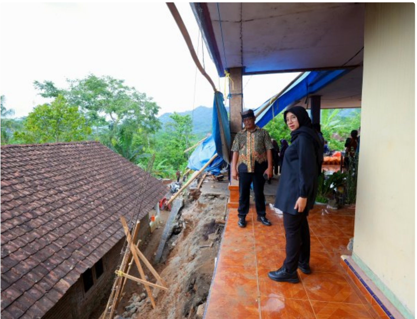
Bupati Banyuwangi Ipuk Fiestiandani meninjau langsung kondisi rumah warga yang rusak akibat tanah longsor di Desa Kandangan, Kecamatan Pesanggaran, Selasa (17/12/2024).
